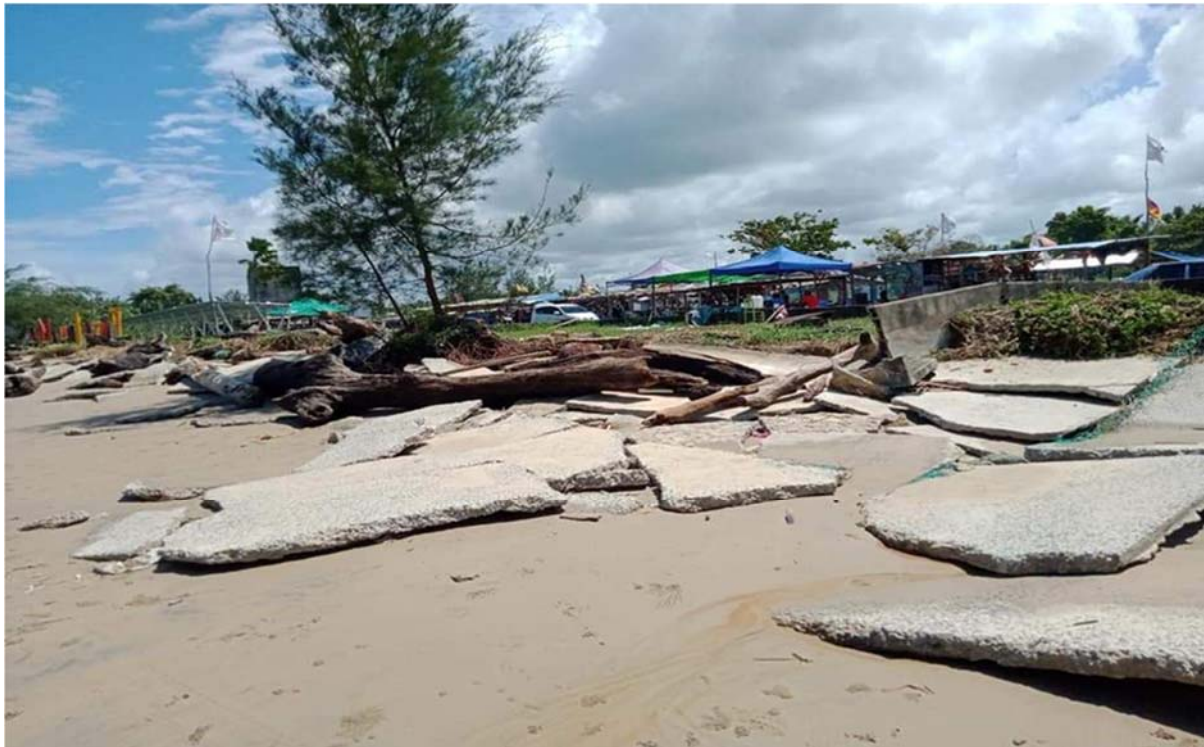
Benteng pemecah ombak runtuh akibat dihempas ombak
