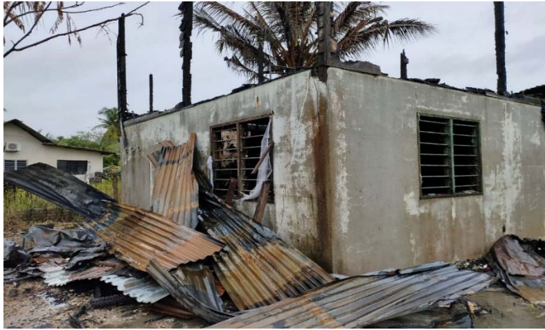
Keadaan Rumah Selepas Kebakaran. Sumber Foto: Athirah Ramli
