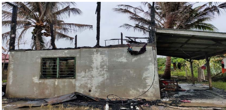
Keadaan Rumah Selepas Kebakaran Sumber Foto: Athirah Ramli
