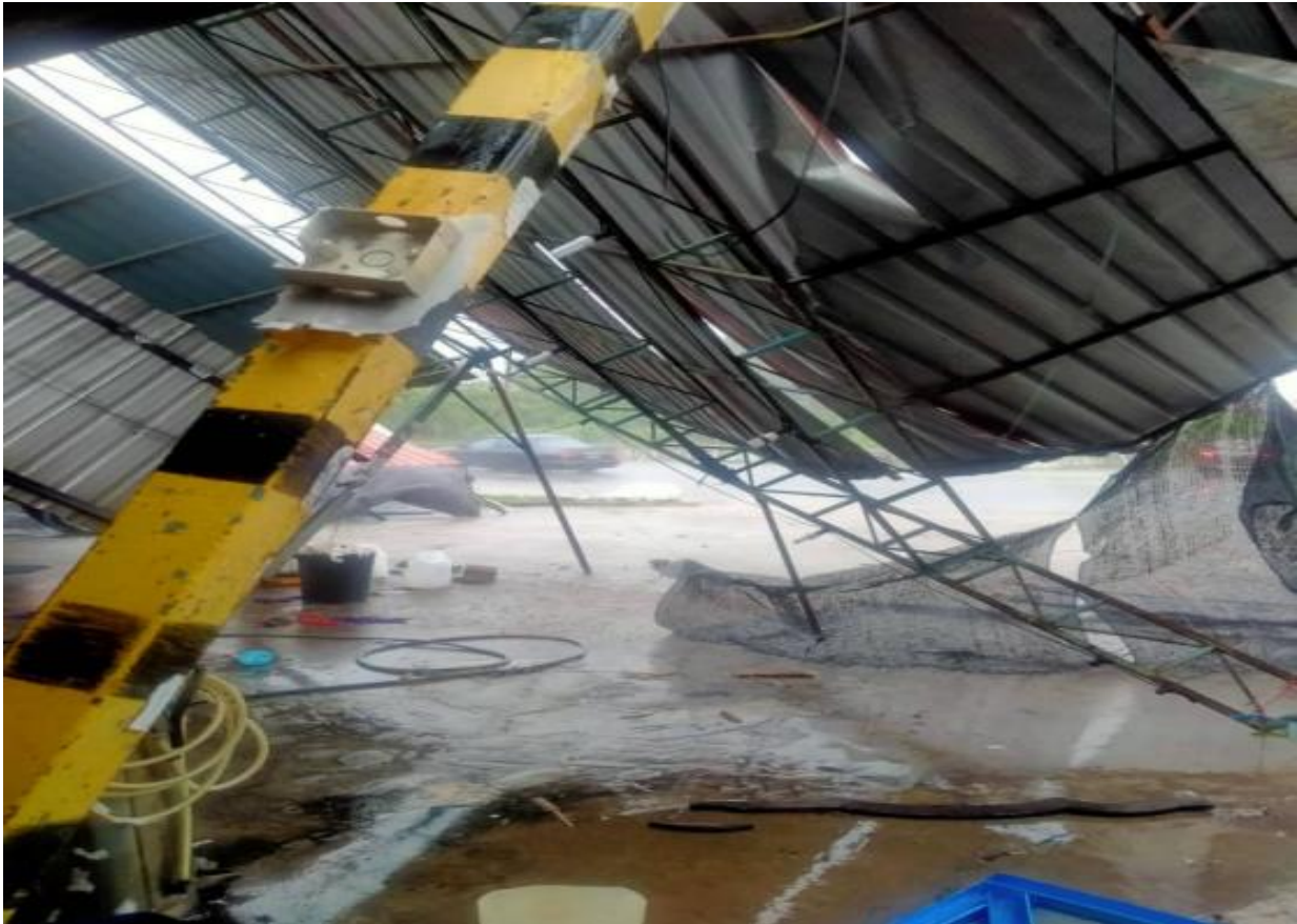
Bumbung kedai dan perkakas elektrik yang rosak teruk. FOTO FAQIH ISMAIL
