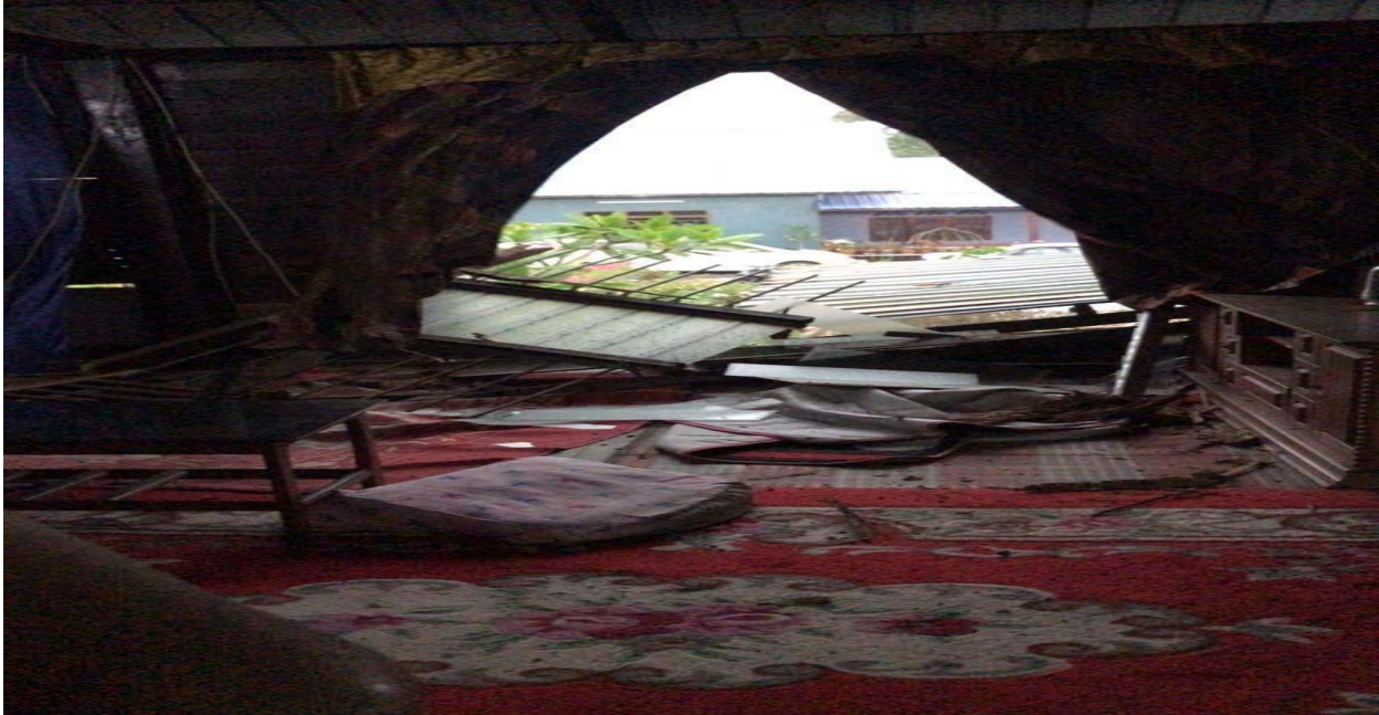
Keadaan dinding rumah Hidayat (mangsa) roboh akibat ribut di Kampung Sijangkang, Selangor.
